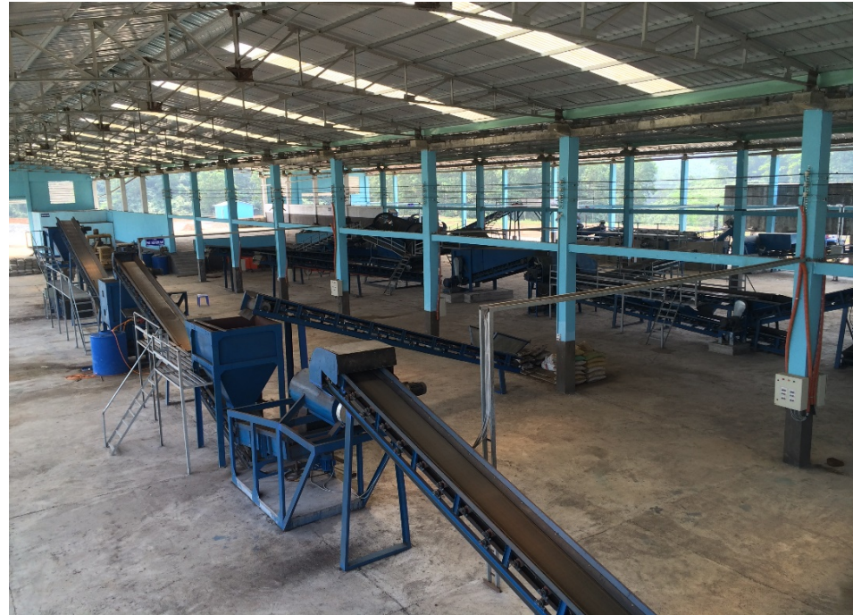
Dây chuyền đốt rác thải sinh hoạt - Yên Bái
