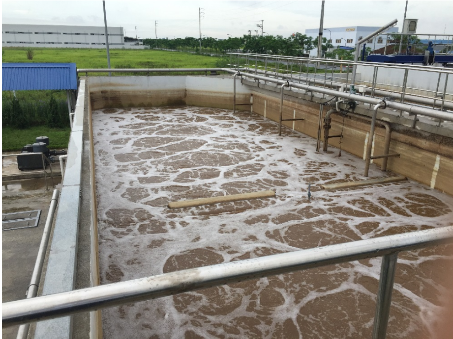
Nhà máy xử lý nước thải tập trung KCN Hòa Mạc – Hà Nam
