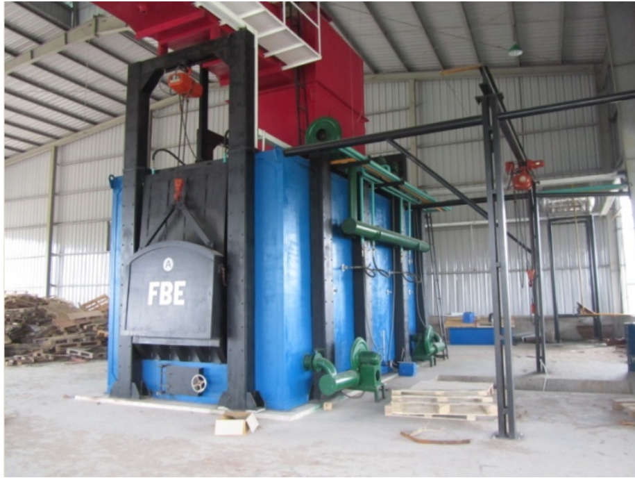
Lò đốt chất thải nguy hại - Bắc Ninh
